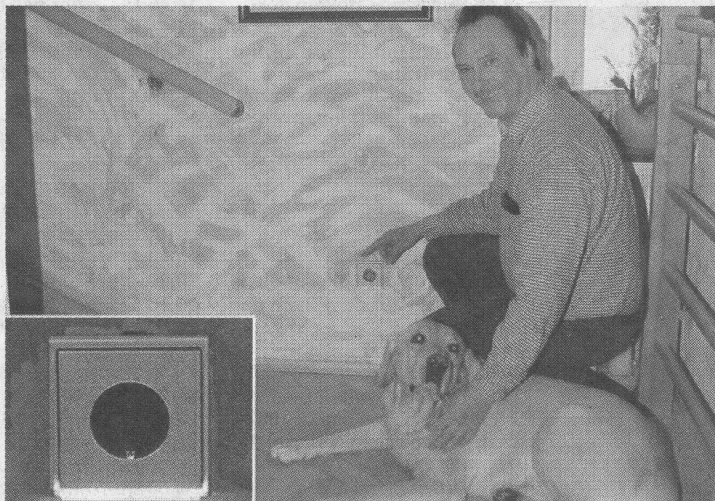
Der Elektromeister präsentiert eine beleuchtete Steckdose.
